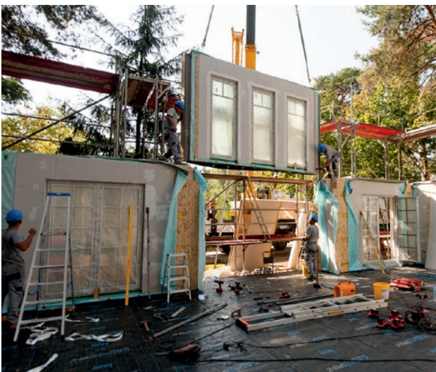
...und das Erdgeschoss auf das Fundament montiert. Anschließend wird das Obergeschoss aufgesetzt.
